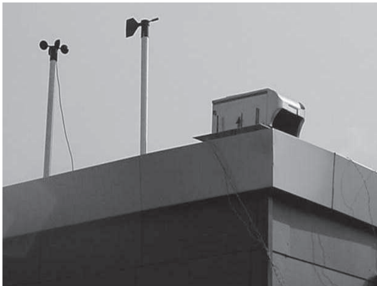
Auf dem Dach des Neubaus: die schuleigene Wetterstation
